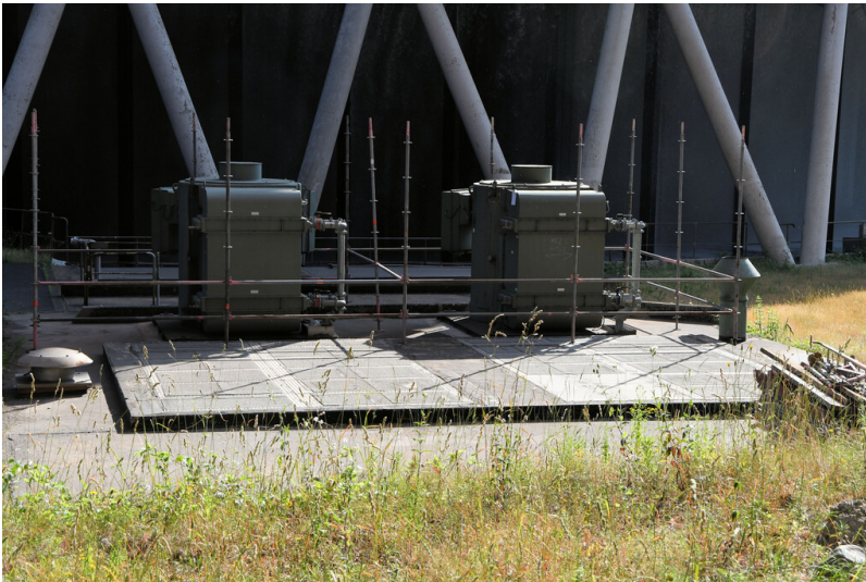
Kraftwerk Weisweiler: Kühlwasser-Pumpenhaus Block G, Ansicht von Südwesten; Foto: 16.06.2023 Fotograf/Urheber: Dr. Norbert Gilson
