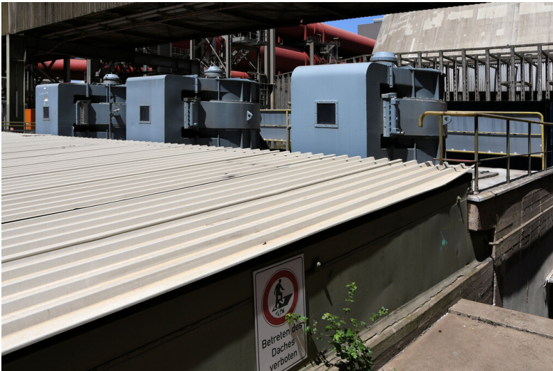
Kraftwerk Weisweiler: Kühlwasser-Pumpenhaus Block F, Ansicht von Süden; Foto: 13.06.2023 Fotograf/Urheber: Dr. Norbert Gilson
