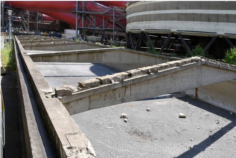
Kraftwerk Weisweiler: zentraler Kühlwasserkanal für die Blöcke A/E, Ansicht von Westen; Foto: 13.06.2023 Fotograf/Urheber: Dr. Norbert Gilson
