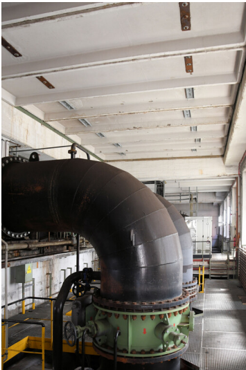
Kraftwerk Weisweiler: Kühlwasser-Pumpenhaus Blöcke A/E, Innenansicht von Westen; Foto: 16.06.2023 Fotograf/Urheber: Dr. Norbert Gilson
