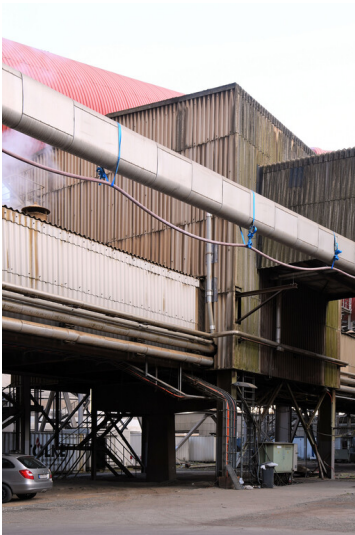
Kraftwerk Weisweiler: Ascheturm 4, Einführungen der Aschebandbrücken von den Blöcken E/F (linke Bildseite) und G/H (rechte Bildseite), Ansicht von Südosten; Foto: 16.03.2023 Fotograf/Urheber: Dr. Norbert Gilson
