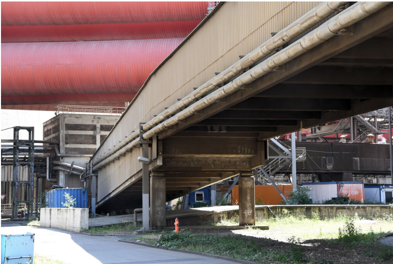
Kraftwerk Weisweiler: Fernascheband am Ausgang von Ascheturm 3, Ansicht von Westen; Foto: 13.03.2023 Fotograf/Urheber: Dr. Norbert Gilson
