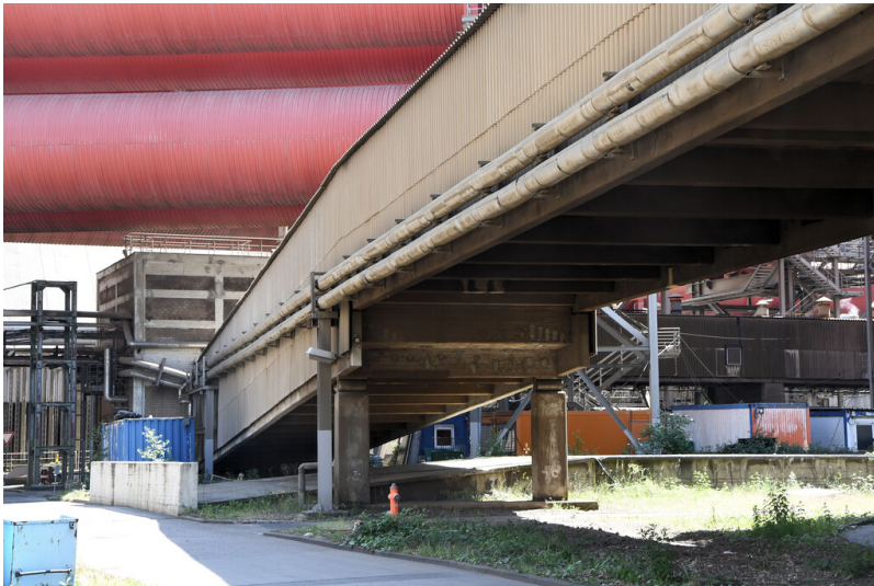
Kraftwerk Weisweiler: Fernascheband am Ausgang von Ascheturm 3, Ansicht von Westen; Foto: 13.03.2023 Fotograf/Urheber: Dr. Norbert Gilson
