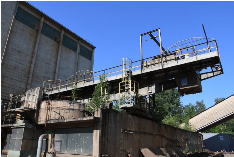
Kraftwerk Weisweiler: Aschebagger, Fahrwerkstütze, Ansicht von Nordosten; Foto: 13.03.2023 Fotograf/Urheber: Dr. Norbert Gilson
