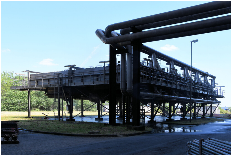
Kraftwerk Weisweiler: REA-Hilfsanlagen, Trockenkühler, Ansicht von Südwesten; Foto: 13.06.2023 Fotograf/Urheber: Dr. Norbert Gilson
