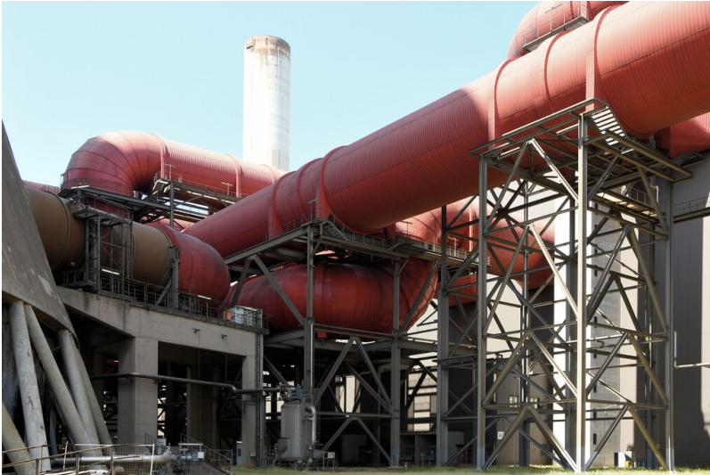
Kraftwerk Weisweiler: Reingasrohre aus Wäscherstraße G, Führung zum Kühlturm G, Ansicht von Südosten; Foto: 13.06.2023 Fotograf/Urheber: Dr. Norbert Gilson
