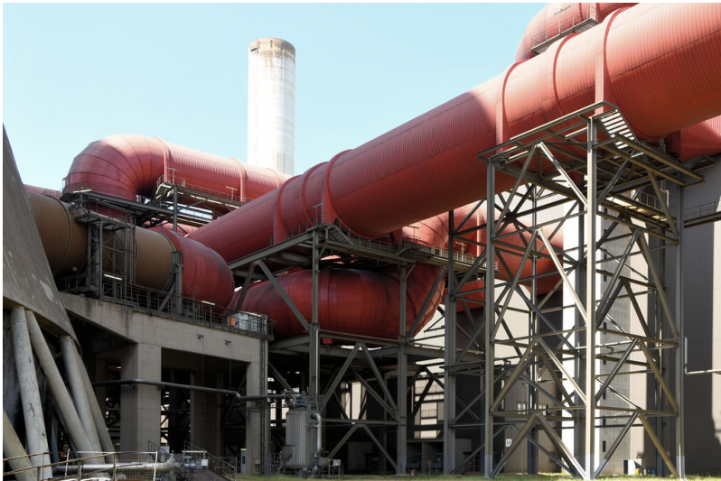
Kraftwerk Weisweiler: Reingasrohre aus Wäscherstraße G, Führung zum Kühlturm G, Ansicht von Südosten; Foto: 13.06.2023 Fotograf/Urheber: Dr. Norbert Gilson
