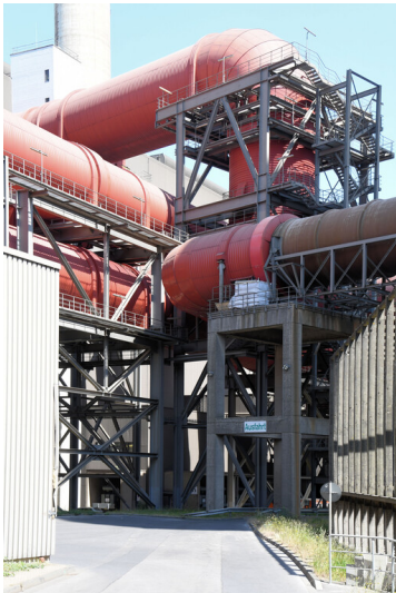
Kraftwerk Weisweiler: Reingasrohre aus Wäscherstraße F, Übergang von Stahl- zu GFK-Rohren, Stütztisch aus Stahlbeton, Ansicht von Westen; Foto: 13.06.2023 Fotograf/Urheber: Dr. Norbert Gilson
