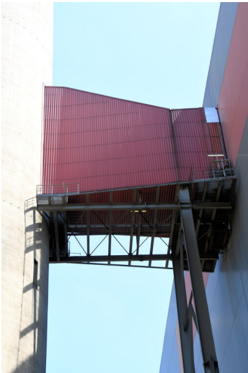
Kraftwerk Weisweiler: Kamin REA Ost, Bypass-Einleitung der Rauchgase aus den Blöcken F, G, H, Ansicht von Westen; Foto: 13.06.2023 Fotograf/Urheber: Dr. Norbert Gilson
