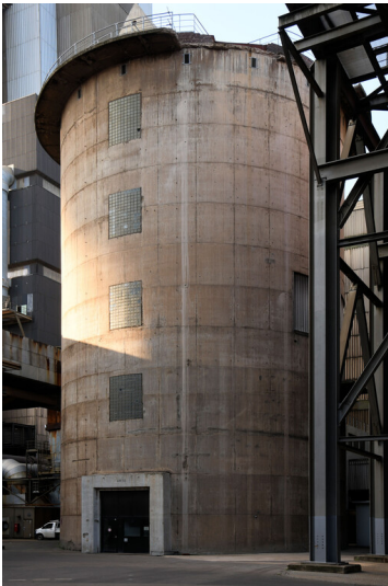
Kraftwerk Weisweiler: Schornstein-Fundamentsockel Block F, Ansicht von Nordwesten; Foto: 16.06.2023 Fotograf/Urheber: Dr. Norbert Gilson
