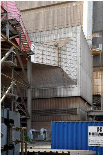
Kraftwerk Weisweiler: Elektrofilter von Block G, Ansicht von Nordwesten; Foto: 16.06.2023 Fotograf/Urheber: Dr. Norbert Gilson
