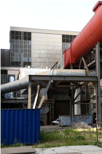
Kraftwerk Weisweiler: Elektrofilter von Block F, Kessel F2, Ansicht von Norden; Foto: 16.06.2023 Fotograf/Urheber: Dr. Norbert Gilson
