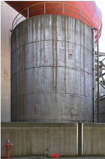
Kraftwerk Weisweiler: Zündölanlage für die Blöcke G und H, Leichtöltank, Ansicht von Norden; Foto: 13.06.2023 Fotograf/Urheber: Dr. Norbert Gilson
