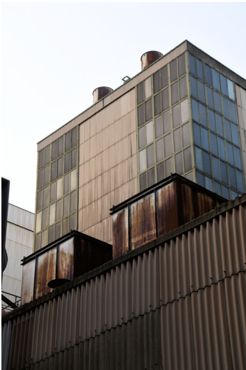
Kraftwerk Weisweiler: Kesselhaus Block D, Ansicht von Nordwesten; Foto: 16.06.2023 Fotograf/Urheber: Dr. Norbert Gilson
