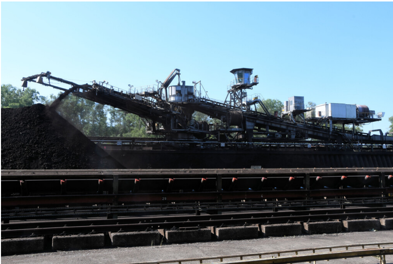
Kraftwerk Weisweiler: Grabenbunker 3, Bandschleifenwagen 981, Ansicht von Nordosten; Foto: 13.06.2023 Fotograf/Urheber: Dr. Norbert Gilson
