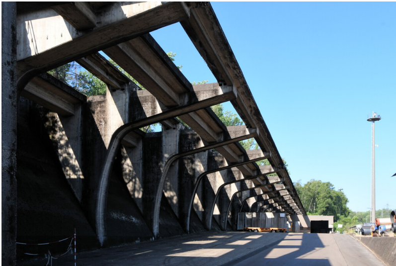
Kraftwerk Weisweiler: Grabenbunker I, Kragarmkonstruktion, Ansicht von Nordosten; Foto: 13.06.2023 Fotograf/Urheber: Dr. Norbert Gilson
