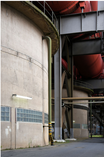
Kraftwerk Niederaußem: Schlammeindicker, Ansicht von Nordwesten; Foto: 17.08.2023 Fotograf/Urheber: Dr. Norbert Gilson
