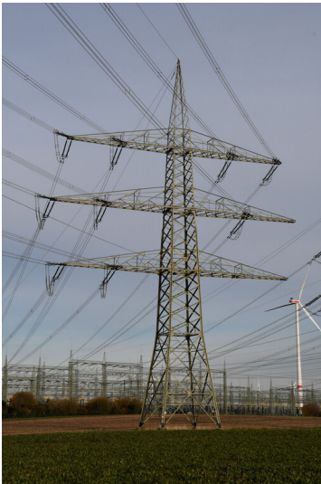
Kraftwerk Niederaußem: Hochspannungsfreileitung von Block H, Einführung in die Umspannanlage Rommerskirchen, Abspannmast M 10A (Bl-Nr. 4589, gemeinsam mit den Leitungen der Blöcke G und K), Ansicht von Südwesten; Foto: 22.11.2023 Fotograf/Urheber: Dr. Norbert Gilson
