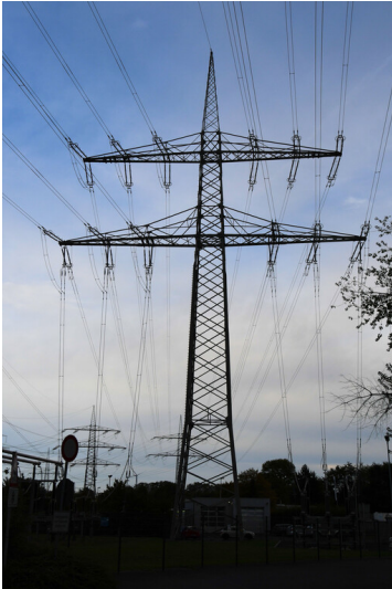
Kraftwerk Niederaußem: Hochspannungsfreileitung von Block E, auf oberer Traverse (linke Seite) von Abspannmast M 3 (BL-Nr. 4548) geführt, Ansicht von Westen; Foto: 23.10.2023 Fotograf/Urheber: Dr. Norbert Gilson
