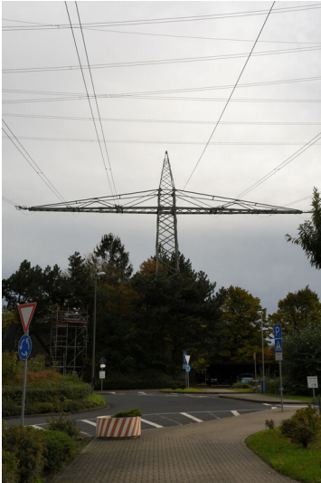
Kraftwerk Niederaußem: Freileitungsabgang Blöcke A/B, Führung der Leitungsseile auf den Abspannmast M 1A (BL-Nr. 4548), Ansicht von Nordwesten; Foto: 23.10.2023 Fotograf/Urheber: Dr. Norbert Gilson
