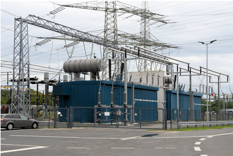
Kraftwerk Niederaußem: Querregler, Ansicht von Nordwesten; Foto: 15.08.2023 Fotograf/Urheber: Dr. Norbert Gilson
