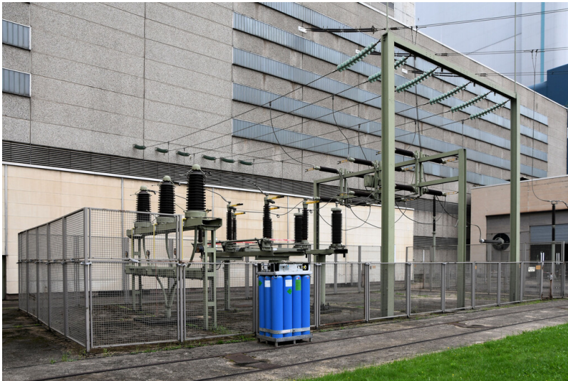
Kraftwerk Niederaußem: Anfahranlage 4, Schaltfeld, Ansicht von Süden; Foto: 17.08.2023 Fotograf/Urheber: Dr. Norbert Gilson
