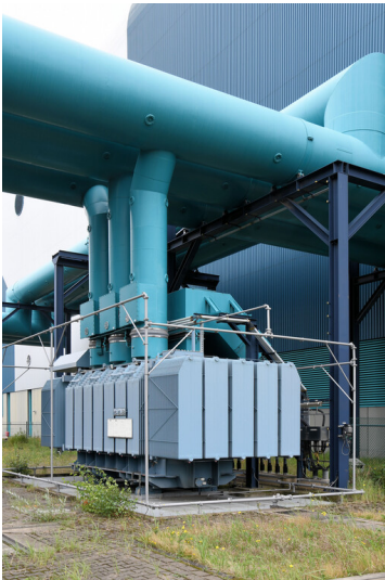
Kraftwerk Niederaußem: Transformatorfeld Block K, Eigenbedarfstransformator (zweites Exemplar baugleich), Ansicht von Südosten; Foto: 17.08.2023 Fotograf/Urheber: Dr. Norbert Gilson
