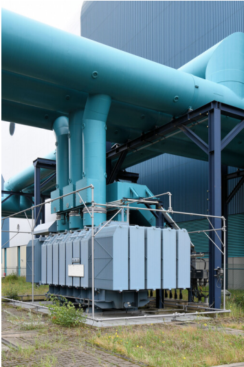
Kraftwerk Niederaußem: Transformatorenfeld Block K, Eigenbedarfstransformator (zweites Exemplar baugleich), Ansicht von Südosten; Foto: 17.08.2023 Fotograf/Urheber: Dr. Norbert Gilson
