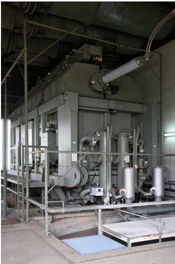
Kraftwerk Niederaußem: Transformatorfeld Block H, Maschinentrafofeld, Innenansicht; Foto: 17.08.2023 Fotograf/Urheber: Dr. Norbert Gilson
