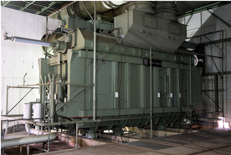
Kraftwerk Niederaußem: Transformatorfeld Block G, Maschinentransformatorpol, Innenansicht von Norden; Foto: 17.08.2023 Fotograf/Urheber: Dr. Norbert Gilson
