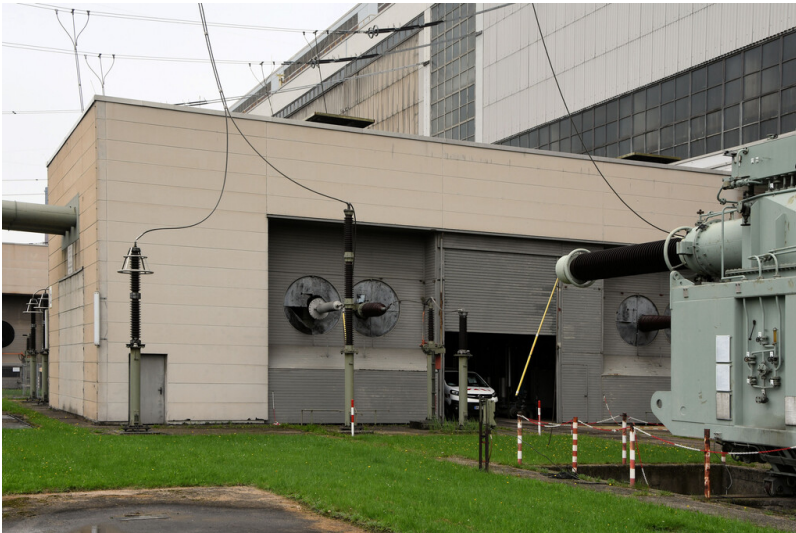
Kraftwerk Niederaußem: Transformatorenfeld Block E, Einhausung der Maschinentrafos, Ansicht von Osten; Foto: 17.08.2023 Fotograf/Urheber: Dr. Norbert Gilson
