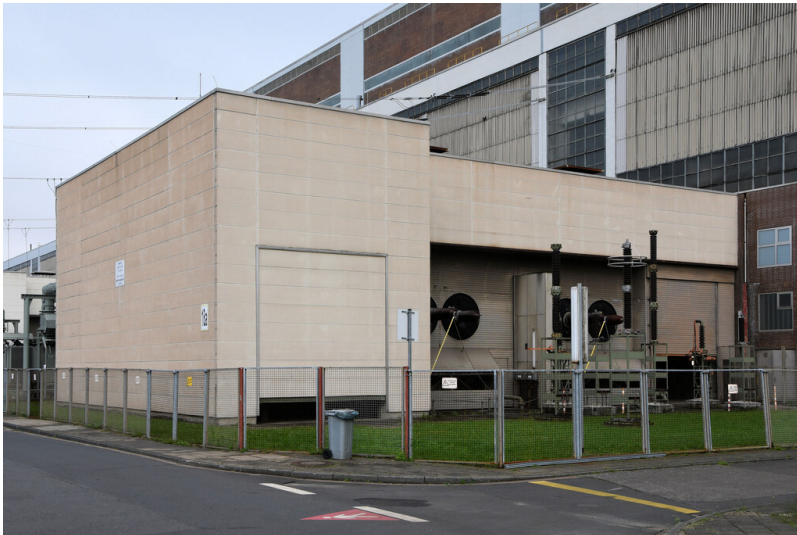
Kraftwerk Niederaußem: Transformatorenfeld Block D, Einhausung der Maschinentrafos, Ansicht von Südosten; Foto: 17.08.2023 Fotograf/Urheber: Dr. Norbert Gilson
