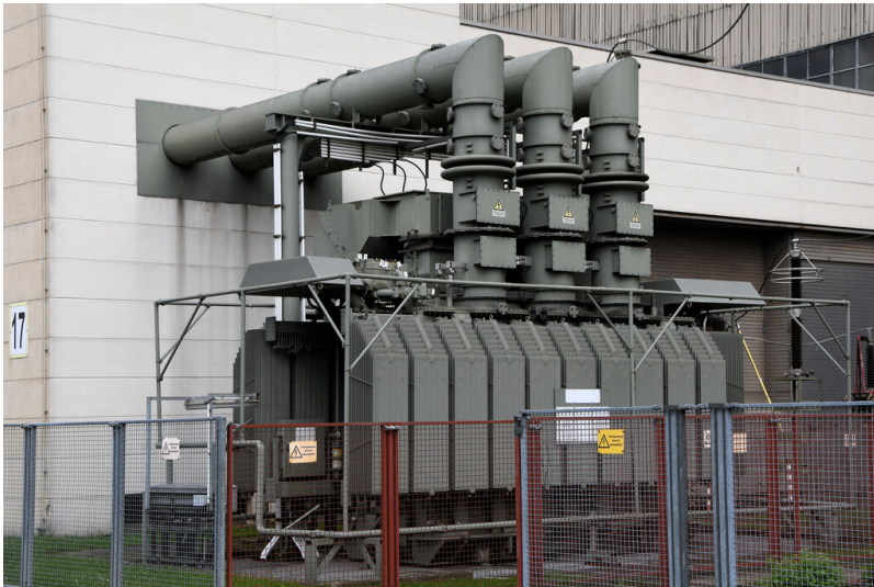
Kraftwerk Niederaußem: REA-Eigenbedarfstrafo Block C, Ansicht von Südosten; Foto: 17.08.2023 Fotograf/Urheber: Dr. Norbert Gilson
