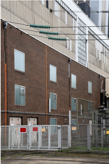
Kraftwerk Niederaußem: Schaltanlagenvorbau, Block C1/C2, östlicher Bauteil, Ansicht von Südwesten; Foto: 17.08.2023 Fotograf/Urheber: Dr. Norbert Gilson
