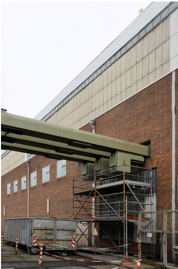
Kraftwerk Niederaußem: Schaltanlagenvorbau, Block B, gekapselte Ausleitung des Maschinentrafo-Anschlusses, Ansicht von Südosten; Foto: 17.08.2023 Fotograf/Urheber: Dr. Norbert Gilson
