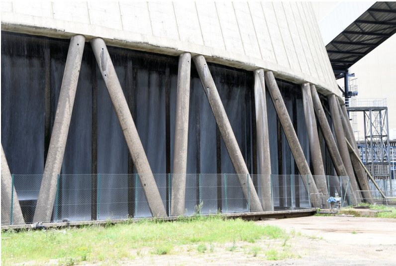
Kraftwerk Niederaußem: Kühlturm H, Schrägstreben und Spannbetonring; Foto: 15.08.2023 Fotograf/Urheber: Dr. Norbert Gilson
