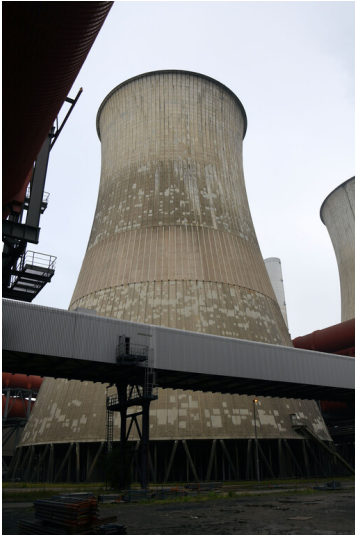
Kraftwerk Niederaußem: Kühlturm E, Ansicht von Süden; Foto: 17.08.2023 Fotograf/Urheber: Dr. Norbert Gilson
