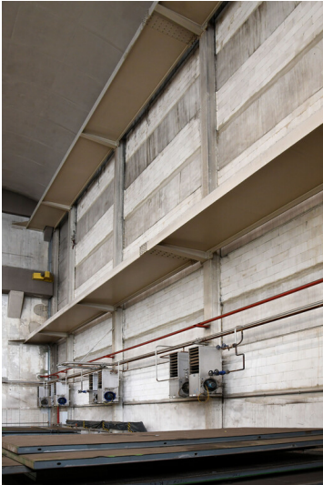
Kraftwerk Niederaußem: Maschinenhaus Block H, offensichtlich ursprünglich als Provisorium angelegte östliche Außenwand, Innenansicht von Süden; Foto: 15.08.2023 Fotograf/Urheber: Dr. Norbert Gilson
