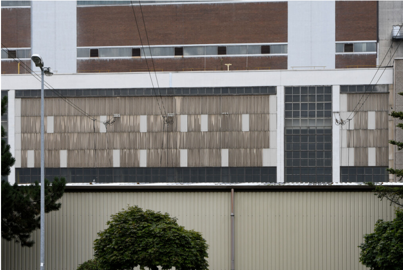
Kraftwerk Niederaußem: Maschinenhaus Block F, Ansicht von Süden; Foto: 15.08.2023 Fotograf/Urheber: Dr. Norbert Gilson
