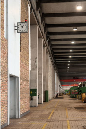
Kraftwerk Niederaußem: Maschinenhaus, Schwerbauseite, Innenansicht von Westen vom Standpunkt Block A; Foto: 15.08.2023 Fotograf/Urheber: Dr. Norbert Gilson
