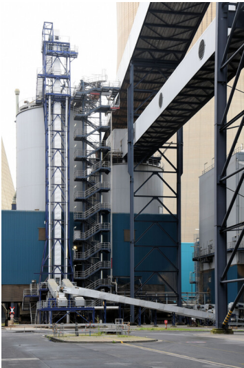
Kraftwerk Niederaußem: Entaschung Block K, Aschesiloanlage, Ansicht von Süden; Foto: 15.08.2023 Fotograf/Urheber: Dr. Norbert Gilson
