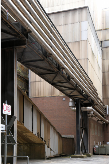
Kraftwerk Niederaußem: Entaschung Block F, Asche-Zwischenbunker Block F und Schrägbandbrücke zur Ascheaufgabe, Ansicht von Nordwesten; Foto: 15.08.2023 Fotograf/Urheber: Dr. Norbert Gilson
