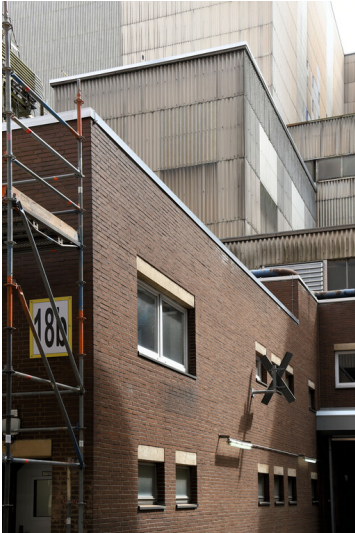
Kraftwerk Niederaußem: Entaschung Block E, Asche-Zwischenbunker, Ansicht von Nordwesten; Foto: 15.08.2023 Fotograf/Urheber: Dr. Norbert Gilson
