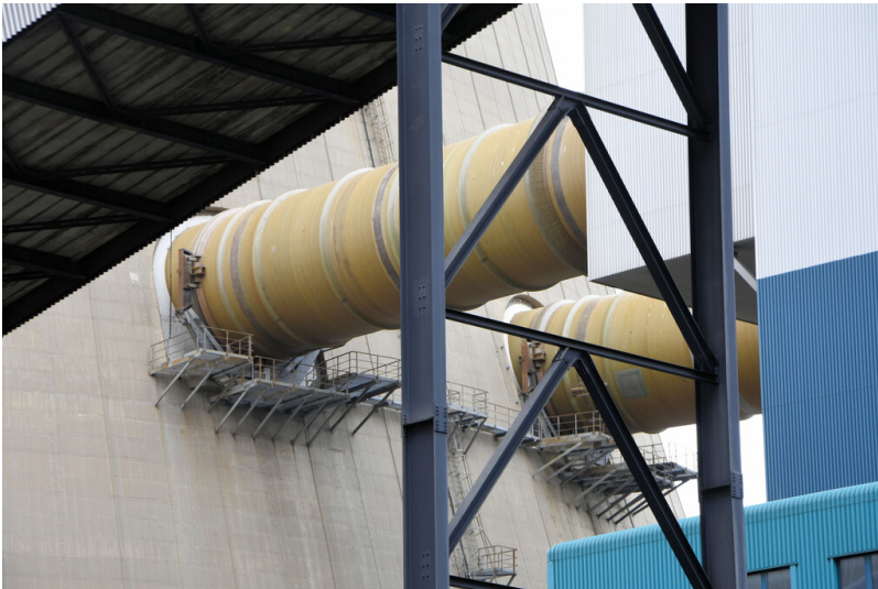
Kraftwerk Niederaußem: Reingaseinleitung in den Naturzug-Kühlturm K, Ansicht von Südwesten; Foto: 15.08.2023 Fotograf/Urheber: Dr. Norbert Gilson
