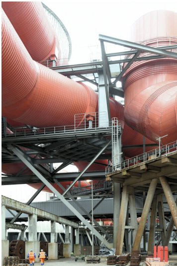
Kraftwerk Niederaußem: Reingaseinleitung Kühlturm H, Rohgasrohre G/H und Reingasrohr H (rechts), Ansicht von Süden; Foto: 15.08.2023 Fotograf/Urheber: Dr. Norbert Gilson
