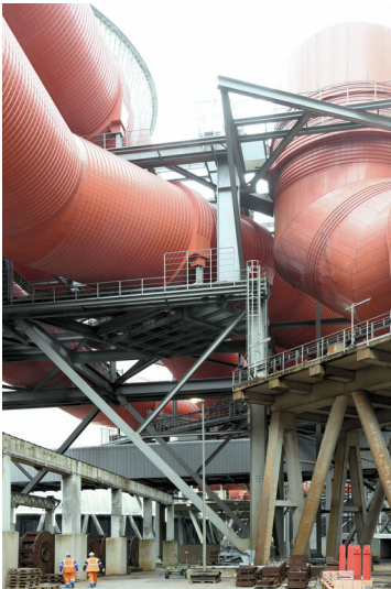
Kraftwerk Niederaußem: Reingaseinleitung Kühlturm H, Rohgasrohre G/H und Reingasrohr H (rechts), Ansicht von Süden; Foto: 15.08.2023 Fotograf/Urheber: Dr. Norbert Gilson
