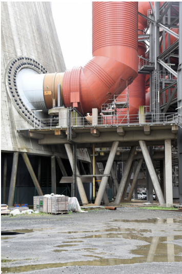
Kraftwerk Niederaußem: Reingaseinleitung Kühlturm F, Ansicht von Norden; Foto: 15.08.2023 Fotograf/Urheber: Dr. Norbert Gilson
