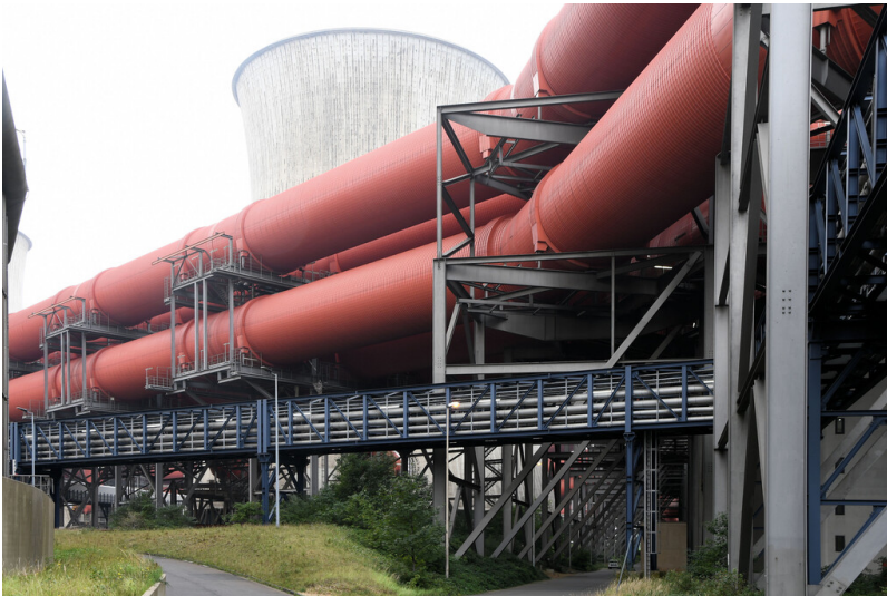
Kraftwerk Niederaußem: Rohgaskanäle Blöcke G und H, kurz vor Einführung in das REA-Wäschergebäude, Ansicht von Nordosten; Foto: 17.08.2023 Fotograf/Urheber: Dr. Norbert Gilson
