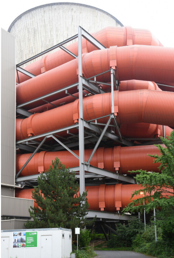
Kraftwerk Niederaußem: Rohgas- und Reingasrohre Blöcke D, E, F (obere Rohre) und Blöcke A, B, C1/C2 (unten), Ansicht von Westen; Foto: 15.08.2023 Fotograf/Urheber: Dr. Norbert Gilson
