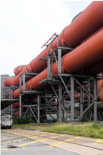
Kraftwerk Niederaußem: Rohgasrohre Blöcke A, B, C1/C2, Ansicht von Süden; Foto: 17.08.2023 Fotograf/Urheber: Dr. Norbert Gilson
