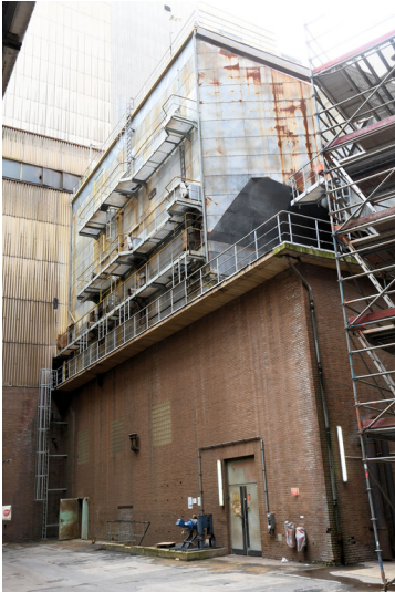
Kraftwerk Niederaußem: Elektrofilter Block E, Ansicht von Norden; Foto: 15.08.2023 Fotograf/Urheber: Dr. Norbert Gilson
