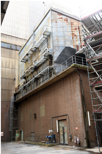
Kraftwerk Niederaußem: Elektrofilter Block E, Ansicht von Norden; Foto: 15.08.2023 Fotograf/Urheber: Dr. Norbert Gilson
