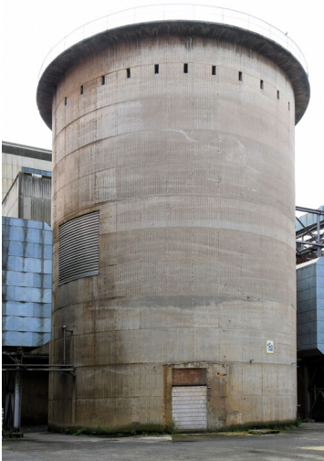
Kraftwerk Niederaußem: Schornstein-Fundamentsockel Blöcke A/B, Ansicht von Norden; Foto: 15.08.2023 Fotograf/Urheber: Dr. Norbert Gilson
