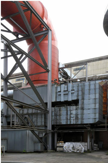
Kraftwerk Niederaußem: Elektrofilter Block B, Ansicht von Nordwesten; Foto: 15.08.2023 Fotograf/Urheber: Dr. Norbert Gilson
