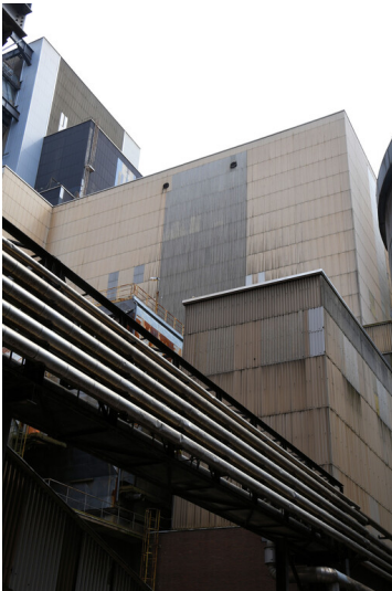
Kraftwerk Niederaußem: Kesselhaus Block F, Ansicht von Nordwesten; Foto: 15.08.2023 Fotograf/Urheber: Dr. Norbert Gilson
